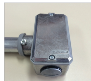
Kit de vedação IP54 instalado.
